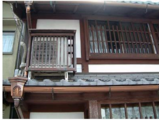
付帯設備の事例
