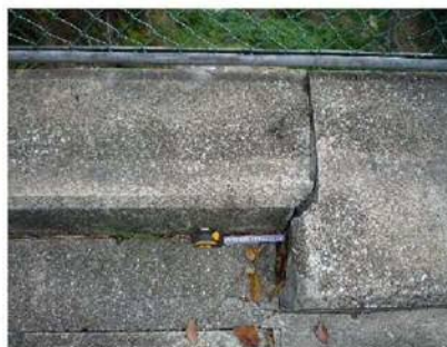
末端部の擁壁上部に見られる 擁壁のズレ
