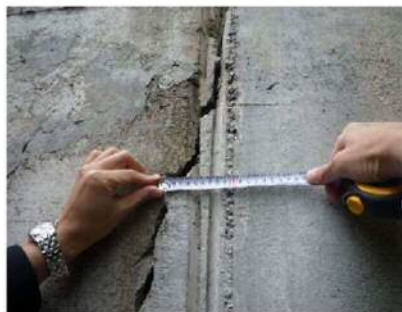
擁壁に見られるクラック （最大開口幅3cm）
