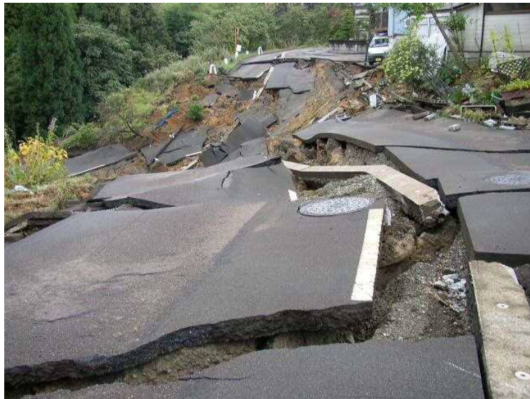
図参 1.1-⑦ 新潟県長岡市高町の盛土造成地の滑動崩落現象その1
