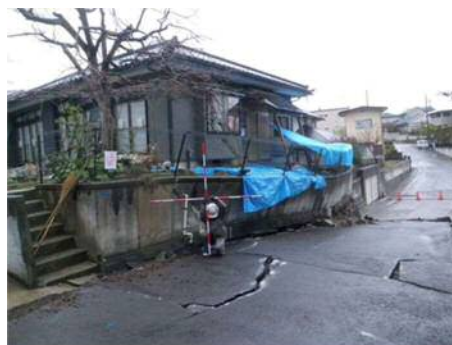
b) 宅地擁壁の崩壊
