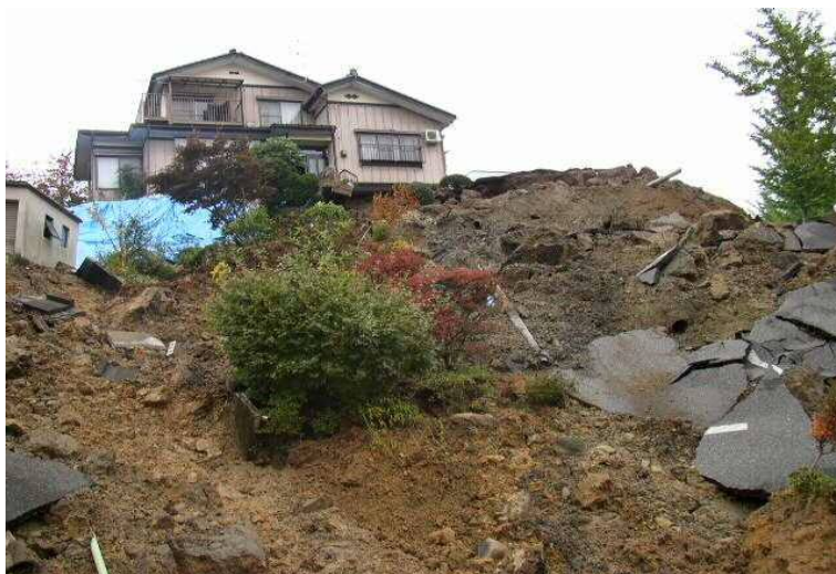
図参 1.1-⑧ 新潟県長岡市高町の盛土造成地の滑動崩落現象その2
