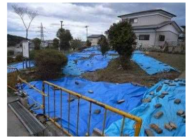
図参2-② 局所的な のり面崩壊
