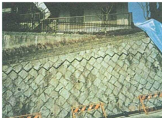
図Ⅶ. 3. 3 擁壁の沈下例 2
