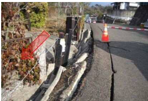
a) 盛土頭部のクラック
