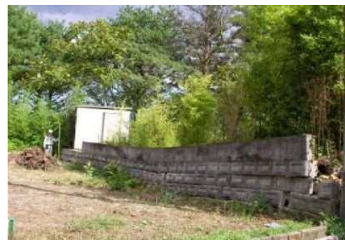
b) 宅地擁壁および基礎地盤の被害
