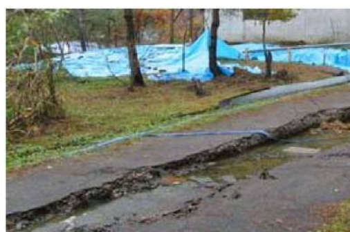
道路の沈下・段差
