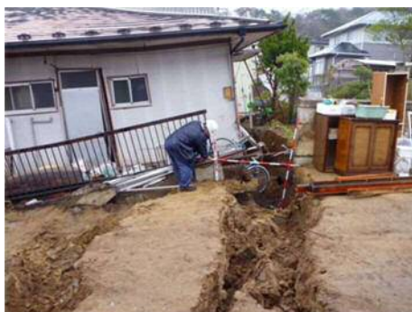
a) 宅地地盤のクラック
