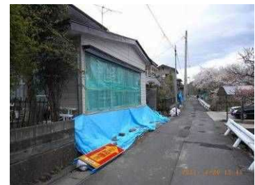
図参2-③ 杭間の変形による 家屋の損壊
