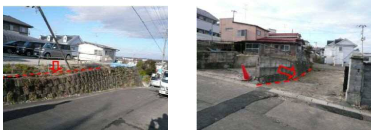
図参 5.4-③ 東北地方太平洋沖地震の仙台市の滑動崩落被害写真（ひな壇部分の変形被害）
