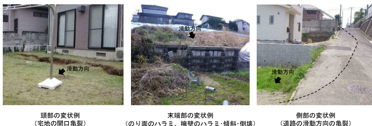
図Ⅲ.2.1 滑動崩落を示唆する変状の例
