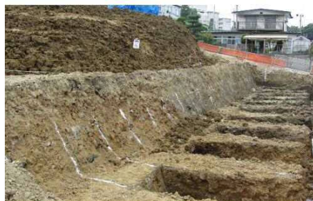
図参 6.1-③ 固結工法（中層混合処理工）の施工状況（N地区の例）
