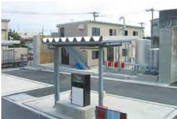
バイオディーゼル給油施設
