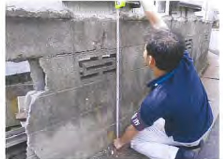
▲危険ブロック計測中
