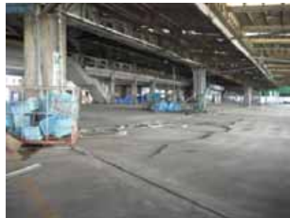
塩竈市魚市場内荷捌き場の陥没・亀裂等
