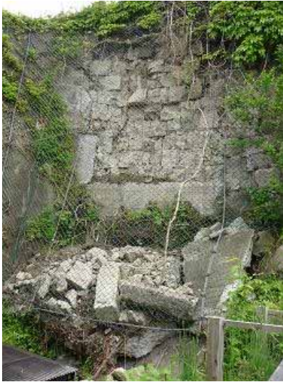
落石（本町分室北側）
