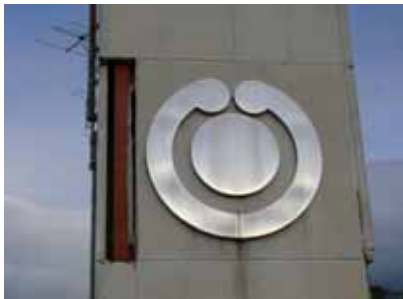
塩竈中央公共駐車場外壁落下等(屋上機械室壁面)
