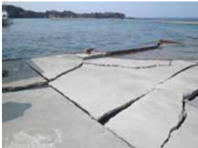
野々島漁港施設の損壊
