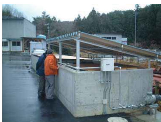
図2-43 排水処理施設
