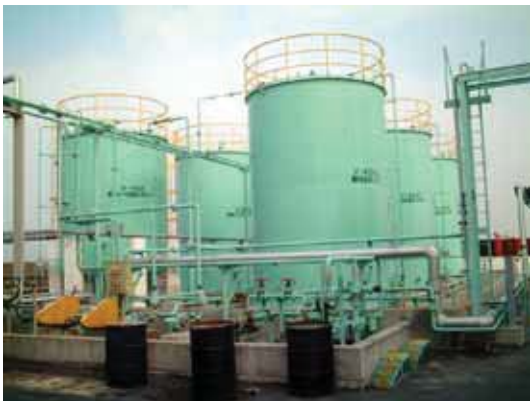
図2-38 BDF 貯蔵タンク
