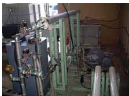
図2-52 排水処理装置（膜処理）
