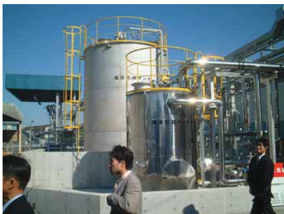
図2-29 BDF貯蔵タンク
