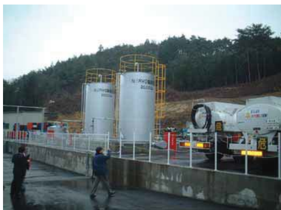
図2-42 B D F 貯蔵タンク
