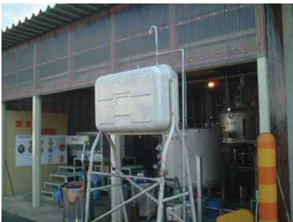
図2-47 B D F 貯蔵タンク
