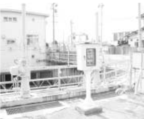
下水道中央ポンプ場
