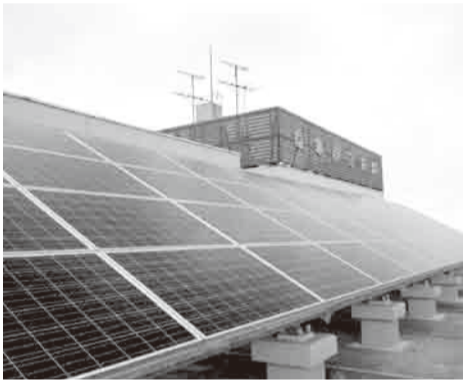
太陽光発電パネル (市立病院)
