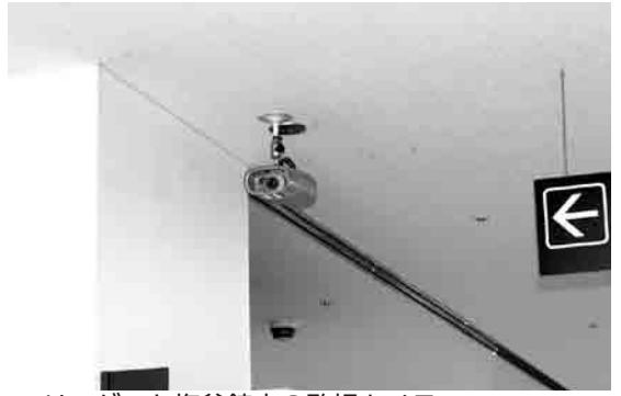
マリングート塩釜館内の監視カメラ
