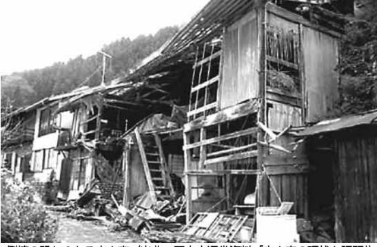
倒壊の恐れのある空き家 (出典：国土交通省資料「空き家の現状と課題」)
