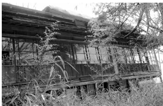
早期の保存・修復が必要な勝画楼の現状
