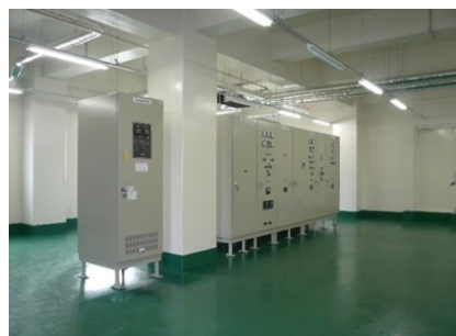
◀建物内部（電気設備）
