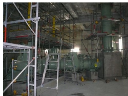
◀建物内部（ポンプ設備）
