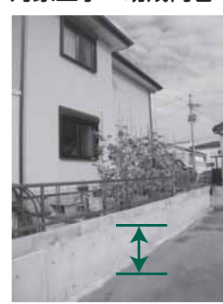
◀50cm以上のかさ上げと新設擁壁工事をした宅地 (尾島町)
