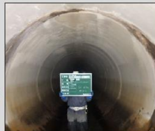
③ 藤倉 1号 幹線 (浸入水)
