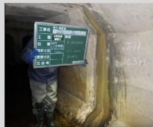
⑥ 新町 2号 幹線 (浸入水)
