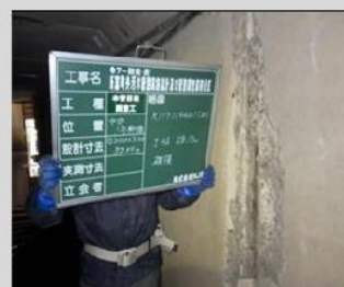
⑧ 中央 1号 幹線 (破損)
