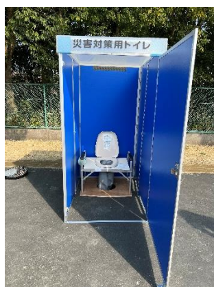
マンホールトイレ正面
