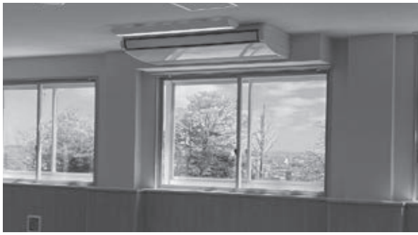
小学校教室のエアコン
