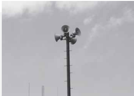
▲同報系防災行政無線のデジタル化
