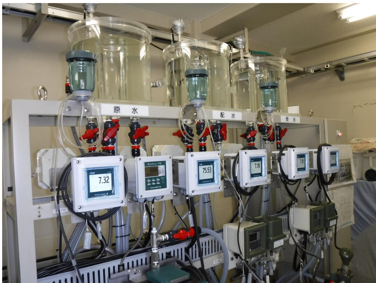
梅の宮浄水場・新設自動水質計
