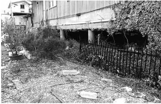
加工団地の地盤沈下による床下の空洞
