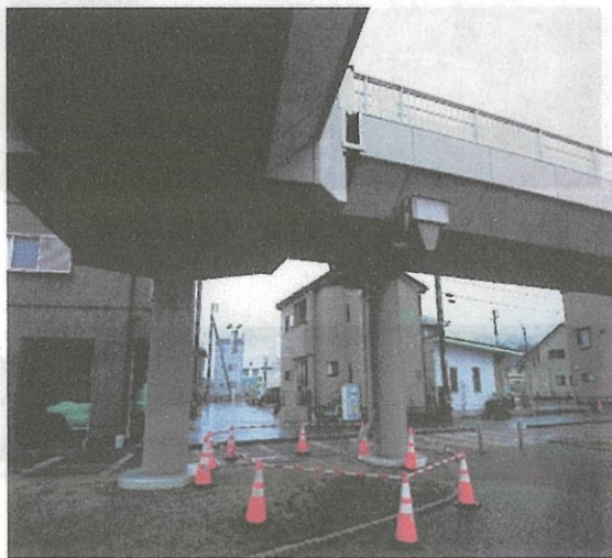
【津波避難デッキ つなぎ目等破損】
