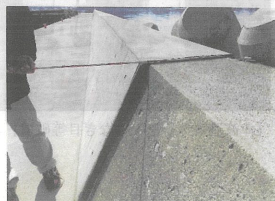
【野野島漁港 北防波堤つなぎ目ズレ】
