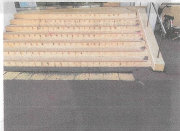
【マリンゲート塩釜 階段下沈下】
