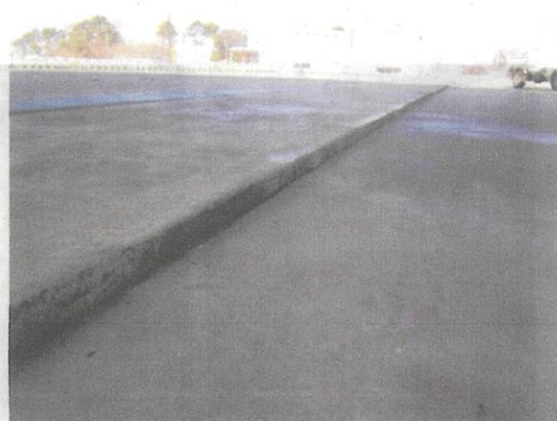
【魚市場西側岸壁 沈下による段差】
