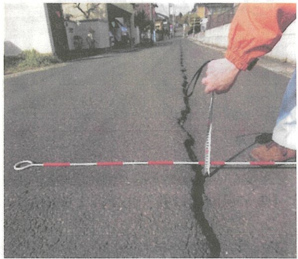
【新浜町市道 クラック】
