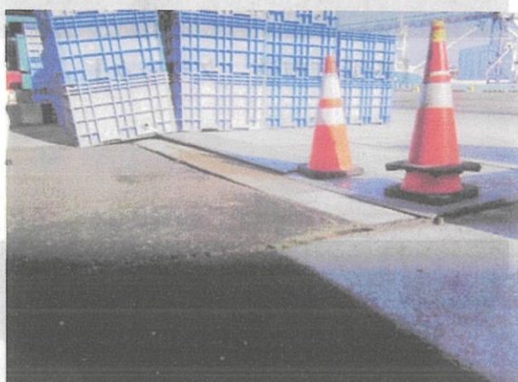
【魚市場東側岸壁 沈下による段差】
