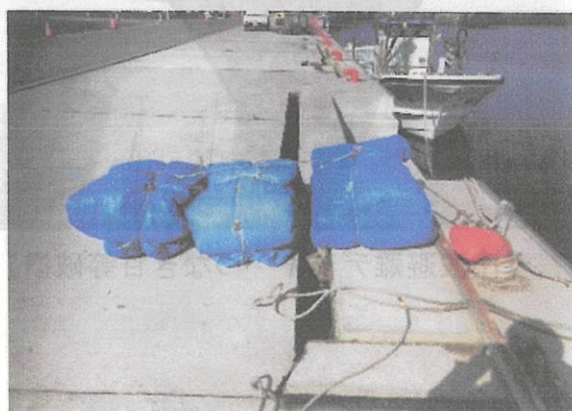
【寒風沢漁港 物揚げ場に段差と隙間】
