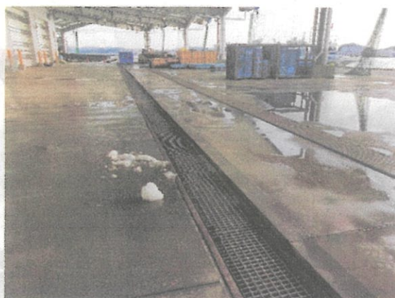
【魚市場南側岸壁 沈下による段差】
