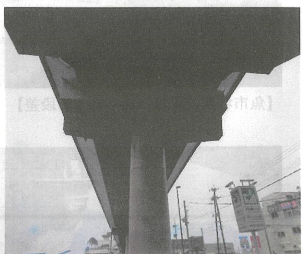
【津波避難デッキ つなぎ目等破損】
