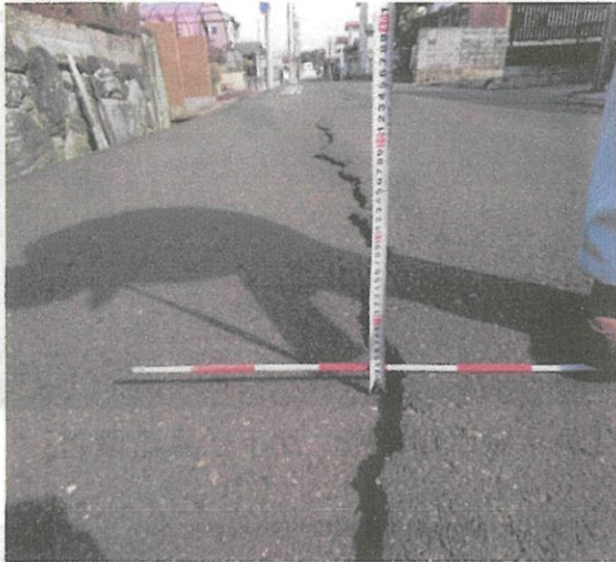
【新浜町市道 クラック】
