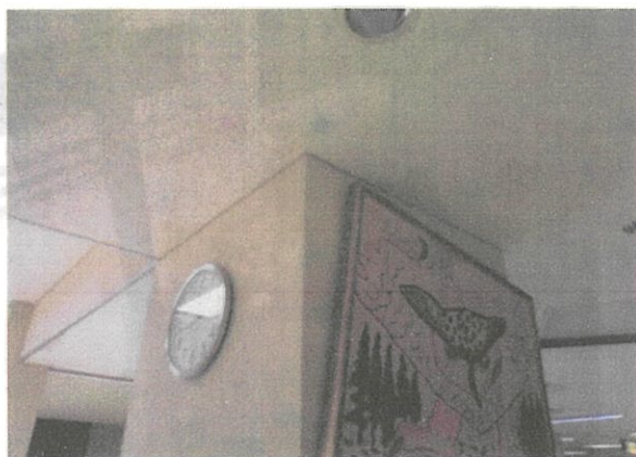
【新市水】市民図書館 漏水状況【水】
