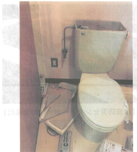
【藤倉保育所 トイレ破損】
