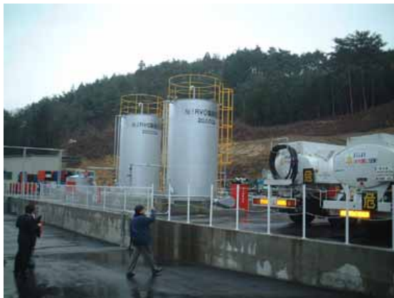
図2-42 B D F 貯蔵タンク
