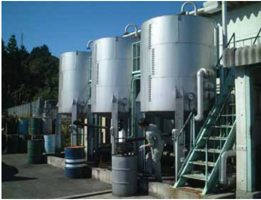
図2-32 原料受入タンク
