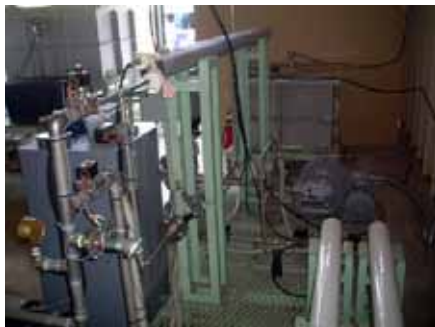
図2-52 排水処理装置 (膜処理)
