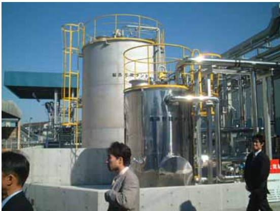
図2-29 B D F 貯蔵タンク
