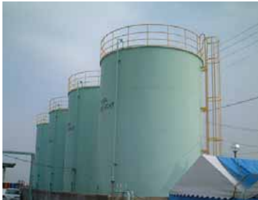
図2-36 原料受入タンク
