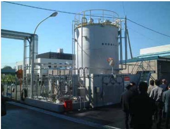
図2-27 原料受入タンク
