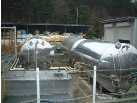
図2-40 原料受入タンク
