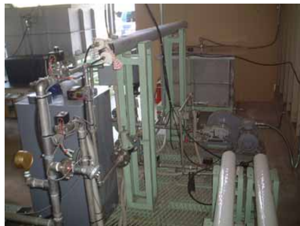
図2-48 排水処理施設
