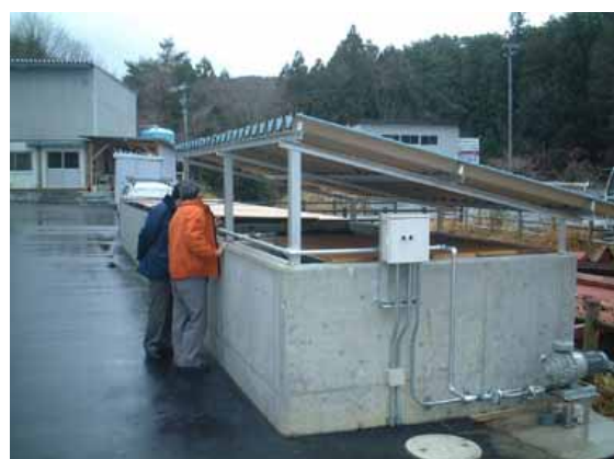
図2-43 排水処理施設
