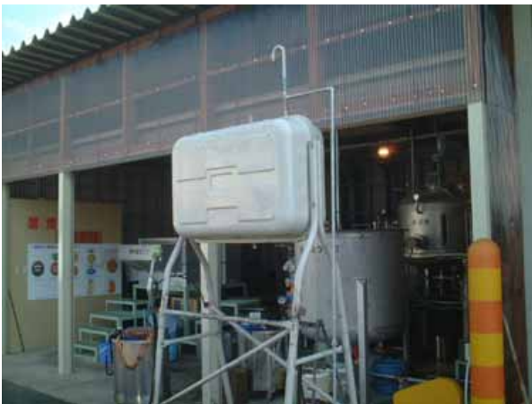
図2-47 B D F 貯蔵タンク
